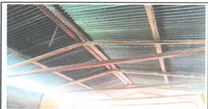
Foto 5: Se necesita el cambio de láminas vieja por lámina nueva acanalada y estructura metálica.
