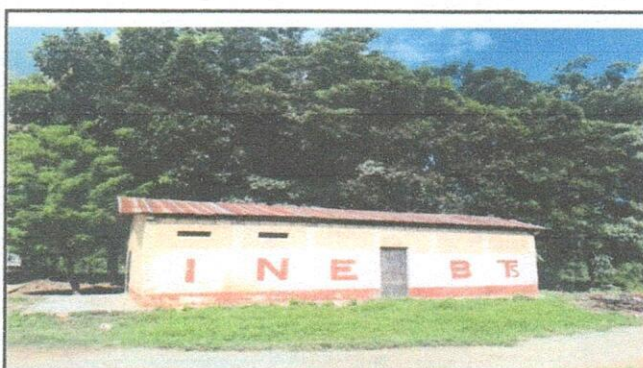
Foto 4: Se observa necesidad en cambio de pintura.
